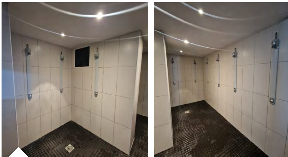
Réfection du carrelage mural et des panneaux de douche des douches collectives (50 000 € TTC)
