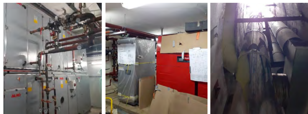
Nouvelle CTA de la Halle Bassins de l'Aquapol, la bache de récupération d'eau pour le lavage des filtres, la chaufferie et le conduit de fumées
